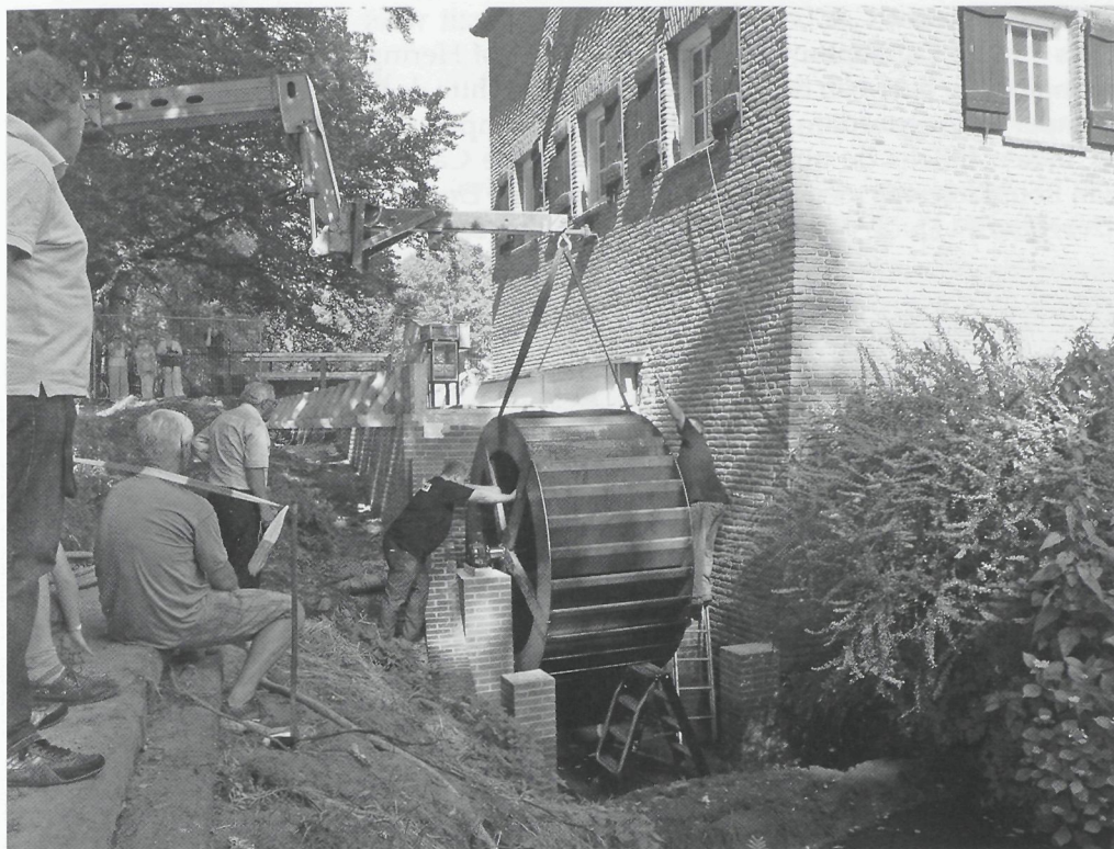
Plaatsing van een nieuw waterrad bij de Cannenburgher Korenmolen op 9 juli 2010. Foto: J. Meijer
