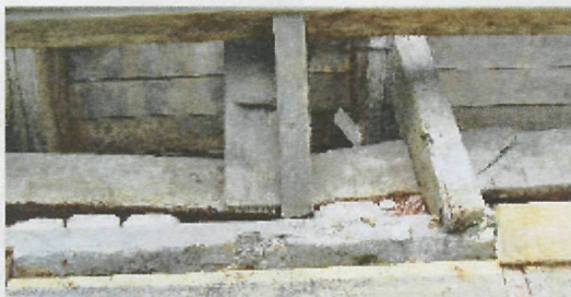
Breuk in muurplaat
